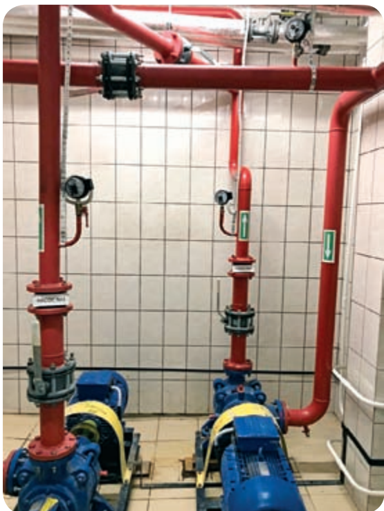
ИНДИВИДУАЛЬНЫЙ ТЕПЛОВОЙ ПУНКТ
